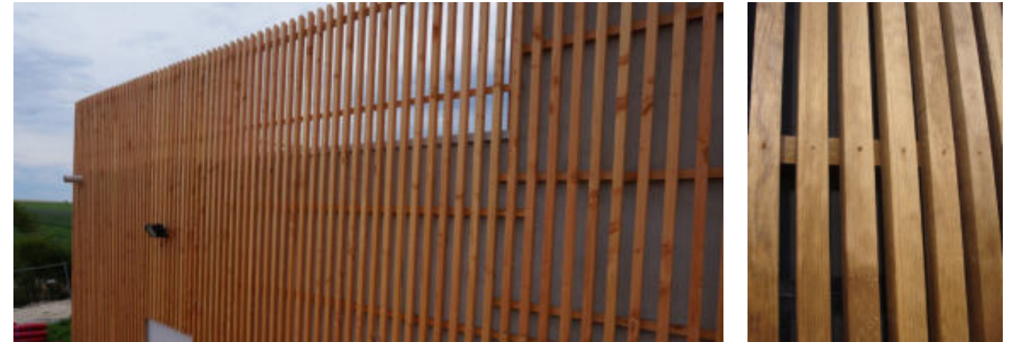
Photographie 257 : Exemple de bardage bois à claire-voie vertical garantissant l'intégration paysagère du poste de livraison tout en évitant l'installation des chiroptères attirés par le confinement.
