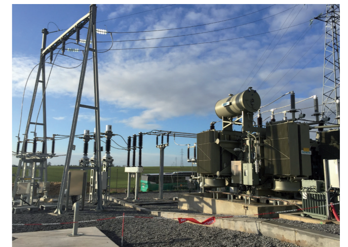
Photographie 145 : Exemple de poste source (source : EOLISE)
