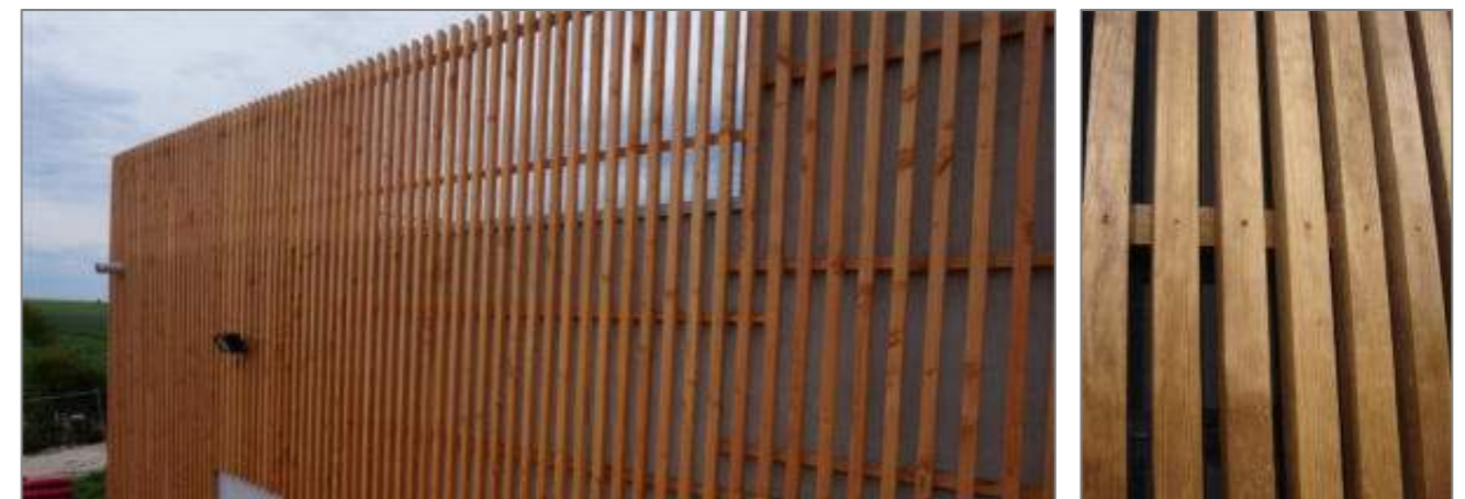
Photographie 50 : Exemple de bardage bois à claire-voie vertical garantissant l'intégration paysagère du poste de livraison tout en évitant l'installation des chiroptères attirés par le confinement
