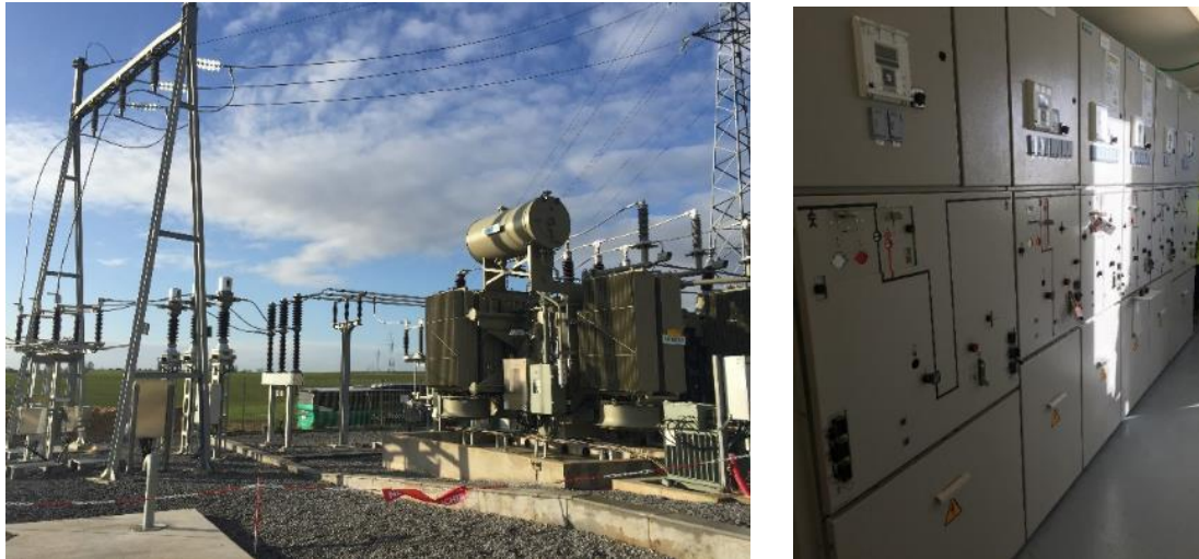
Figure 7 : Exemple de l'extérieur d'un poste source (gauche) et de l'intérieur (droite) (Source : EOLISE)
