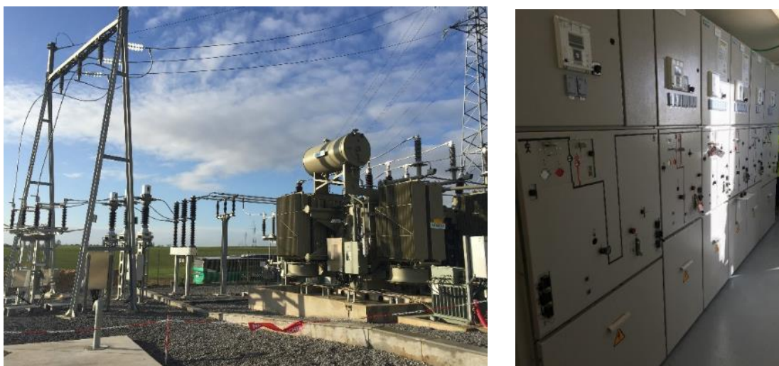
Figure 8 : Exemple de l'extérieur d'un poste source (gauche) et de l'intérieur (droite) (Source : EOLISE)
