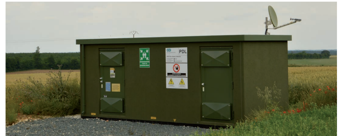
Photographie 194 : Exemple de poste de livraison habillé d'un bardage en bois et dont les portes sont peintes en vert-gris foncé.
