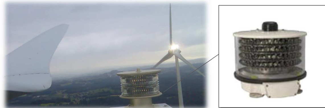
Figure 33 : Balisage d'une éolienne.
