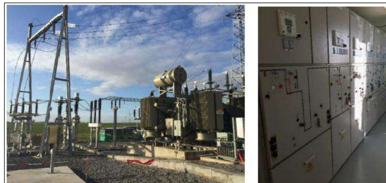
Photographie 34 : Exemple de l'extérieur (à gauche) et de l'intérieur (à droite) d'un poste source (source : EOLISE)
